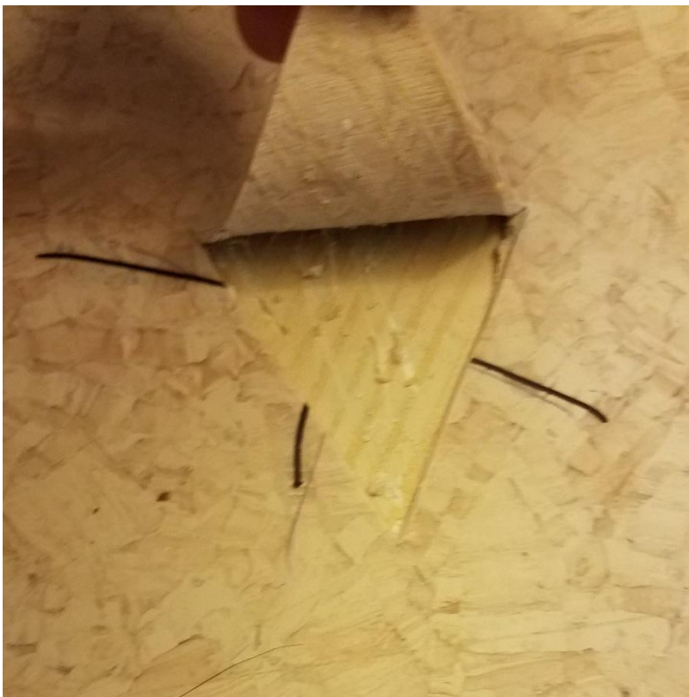
Kuva 12. Pohjakerroksen salin seinusta, jossa oli kohonnut pintakosteustaso. Kohdassa esiintyi mikrobiperäistä hajua.
